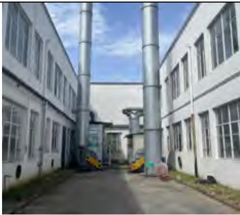
废气处理设施
