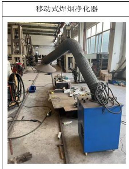
图 3-2 废气处理设施现状
