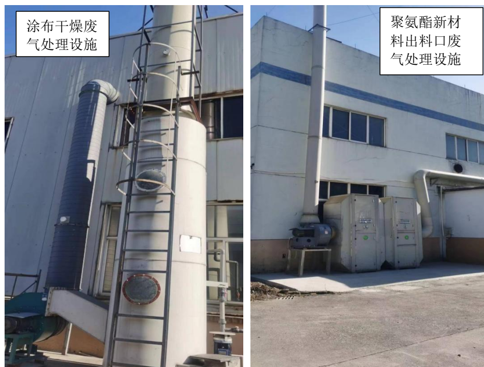
图 2-6 废气处理设施现状
